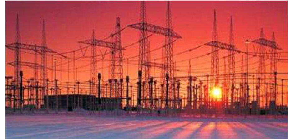
Smartgrid, supervision du réseau électrique
